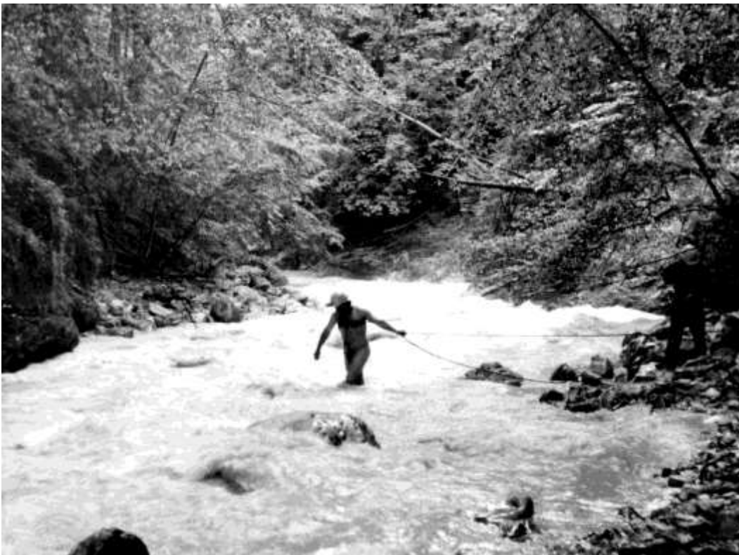
Lumpl muss durch das eiskalte Wasser, um die Gegenstation der Seilbahn zur Höhle Virseci zu bauen (Foto: Manfred Kupetz)
